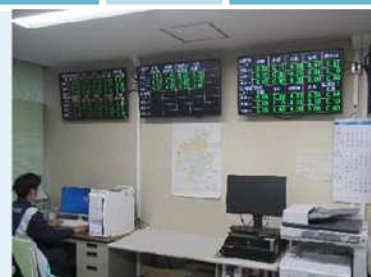
水質監視装置 監視画面
