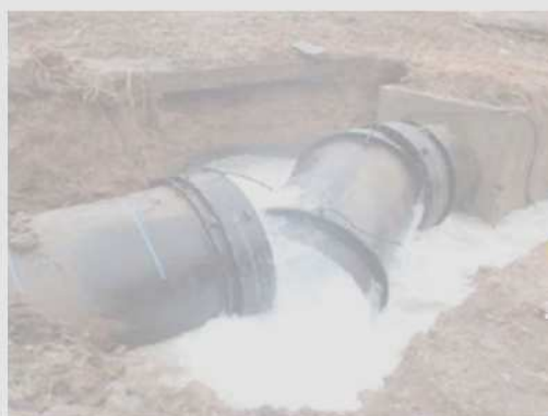
<地震による水道管の継ぎ手の離脱>
