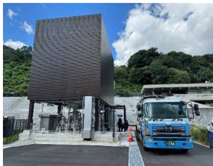
蹴上浄水場粉末活性炭注入設備 （令和6年度運用開始）
