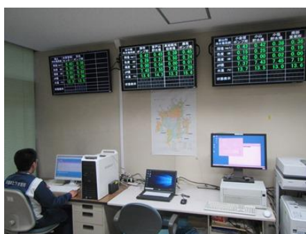
（水質自動監視装置の監視画面）
