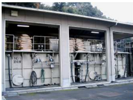
現在の粉末活性炭注入設備
