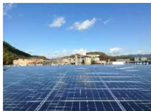
太陽光発電設備（新山科浄水場）
