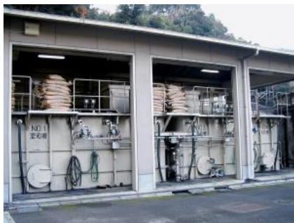
現在の粉末活性炭注入設備
