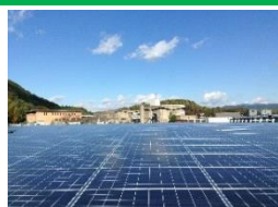
太陽光発電設備（新山科浄水場）
