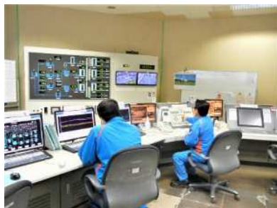
浄水場における運転監視等業務 (写真は松ヶ崎浄水場)
