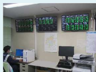
水質監視装置 監視画面
