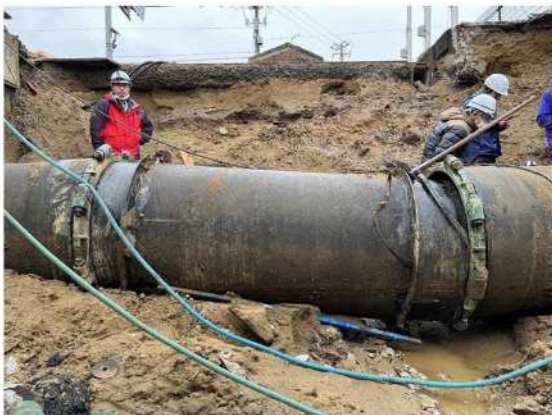
送水管の被害（七尾市）
