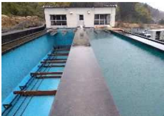
浄水場の被害（珠洲市）
