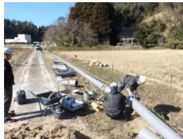
区域の下水を集約し処理場へ送る圧送管の被災（珠洲市熊谷ポンプ場からの圧送管）
