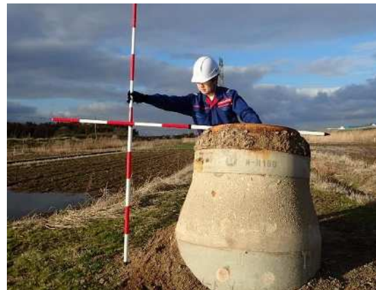
マンホール浮上現場（中能登町）
