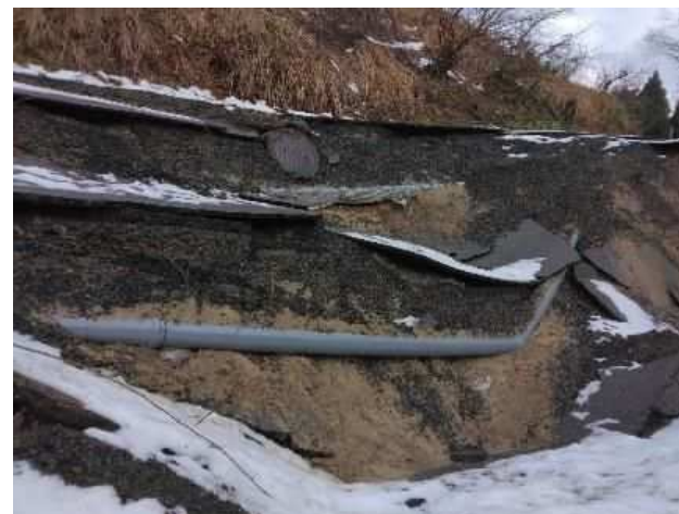
水道水を配水する拠点となる配水池へ送る送水管の被災（輪島市送水管）
