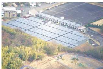
太陽光発電設備 (新山科浄水場)
