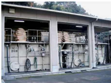
現在の粉末活性炭注入設備
