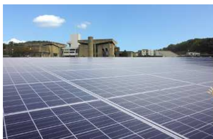
太陽光発電設備（新山科浄水場）
