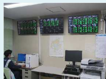
水質監視装置 監視画面
