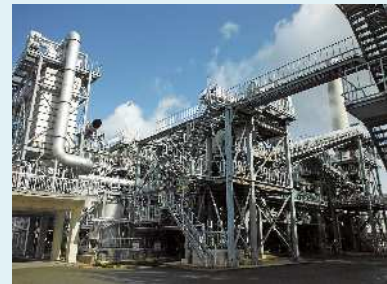
鳥羽水環境保全センター污泥焼却炉
