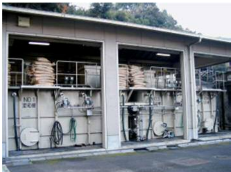
現在の粉末活性炭注入設備
