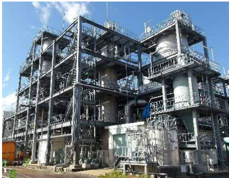
鳥羽水環境保全センター汚泥焼却施設 （流動炉）
