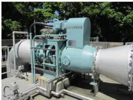
小水力発電設備(石田水環境保全センター) 定格出力：9kW 発電実績：79,820kWh(令和4年度)
