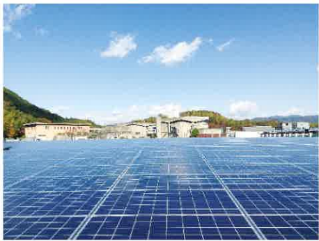
太陽光発電設備(新山科浄水場)
