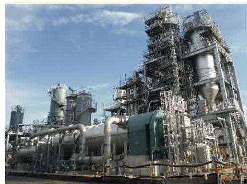
下水污泥固形燃料化炉（鳥羽水環境保全センター）
