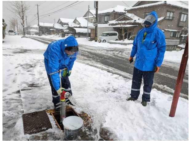
消火栓を活用した通水確認
