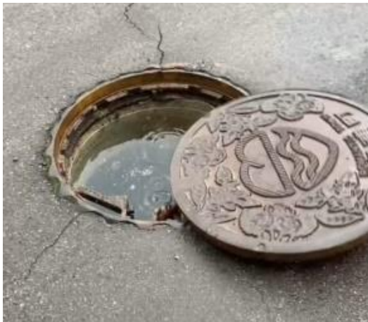
排水できず水が溜まっているマンホール
