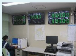
水質監視装置 監視画面
