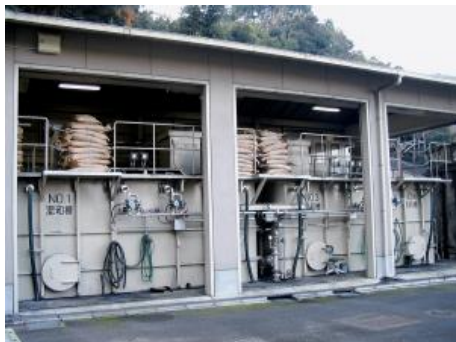
現在の粉末活性炭注入設備
