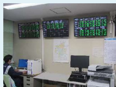
水質監視装置 監視画面
