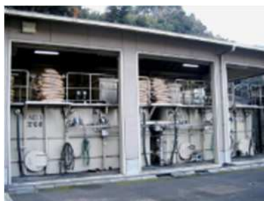
現在の粉末活性炭注入設備
