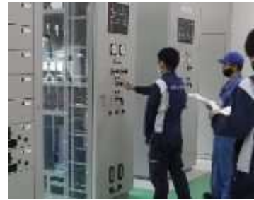
下水道技術研修施設における研修 （電気設備操作実習の様子）
