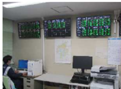
水質監視装置 監視画面
