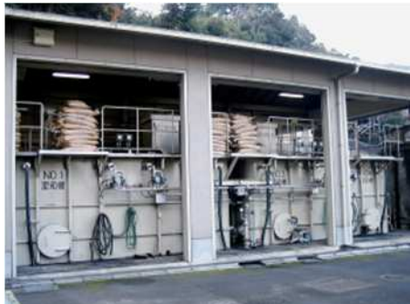
現在の粉末活性炭注入設備
