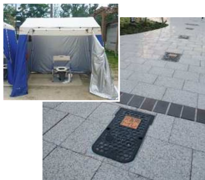
マンホールトイレ （左上は設置時の様子）
