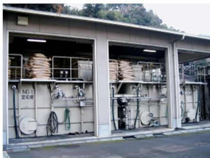
現在の粉末活性炭注入設備
