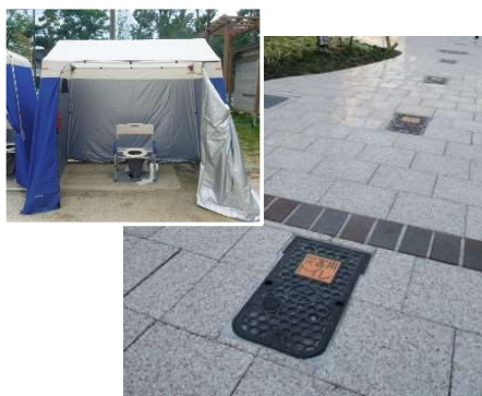
マンホールトイレ （左上は設置時の様子）
