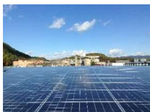
太陽光発電設備（新山科浄水場）
