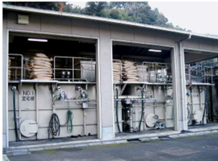
現在の粉末活性炭注入設備
