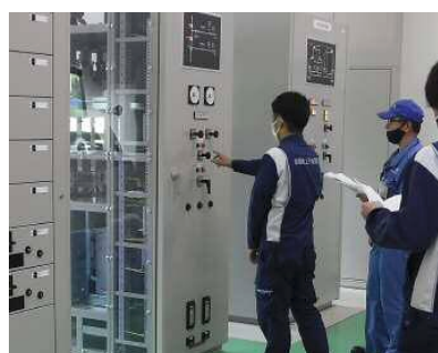
下水道技術研修施設における研修 （電気設備操作実習の様子）
