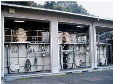
現在の粉末活性炭注入設備
