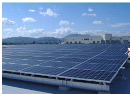
太陽光発電設備（鳥羽水環境保全センター）
