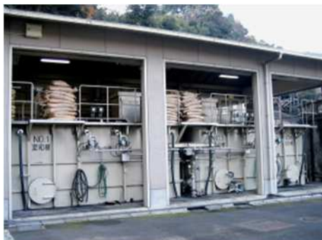
現在の粉末活性炭注入設備
