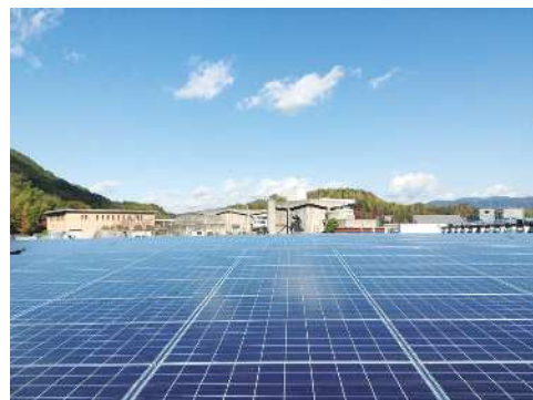
太陽光発電設備（新山科浄水場）
