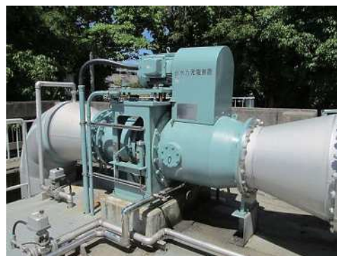
小水力発電設備（石田水環境保全センター） 定格出力：9 kW 発電実績：79,380 kWh（令和3年度）
