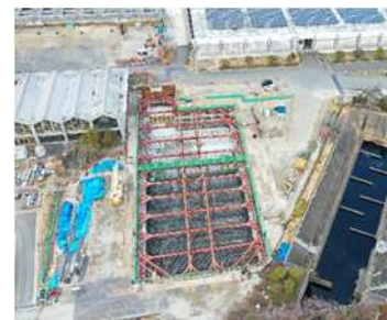
鳥羽水環境保全センター消毒施設 (塩素混和池)
