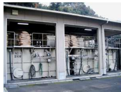
現在の粉末活性炭注入設備
