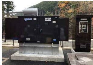
非常用発電設備（山間地域）
