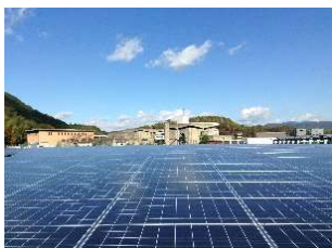
太陽光発電設備（新山科浄水場）
