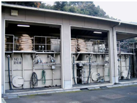
現在の粉末活性炭注入設備
