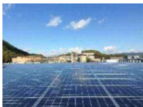
太陽光発電設備（新山科浄水場）
