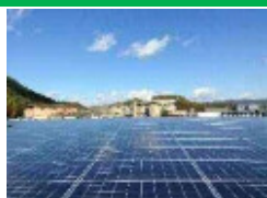
太陽光発電設備（新山科浄水場）
