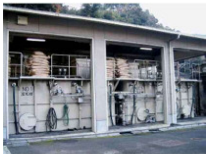
現在の粉末活性炭注入設備
