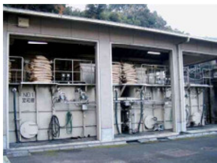
現在の粉末活性炭注入設備
