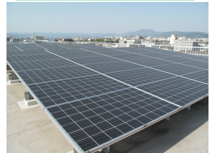
太陽光発電設備
