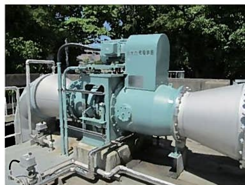
小水力発電設備(石田水環境保全センター) 定格出力：9 kW 発電実績：80,150 kWh(令和2年度)
