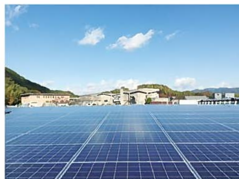
太陽光発電設備(新山科浄水場)
