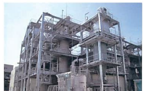
流動床式焼却炉の排煙処理設備
