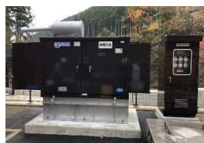
非常用発電設備（山間地域）
