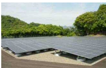
松ヶ崎浄水場の太陽光発電設備
