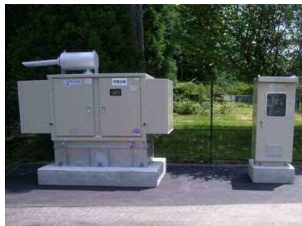
非常用発電設備
