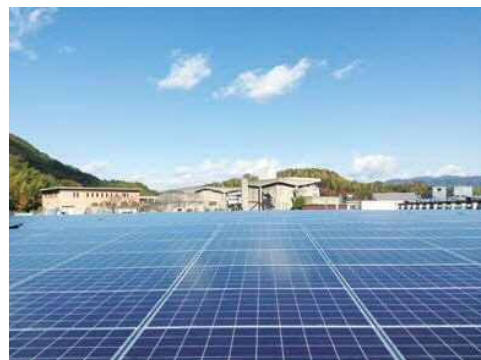
太陽光発電設備（新山科浄水場）
