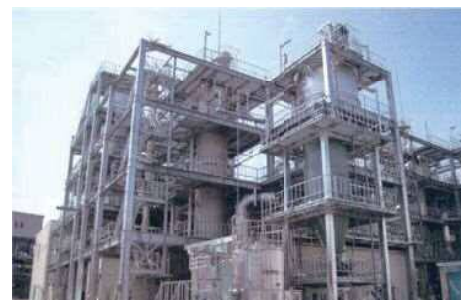
流動床式焼却炉の排煙処理設備
