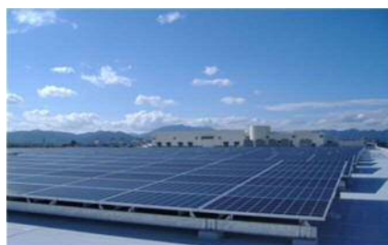
（鳥羽水環境保全センターの太陽光発電設備）
