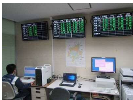
（水質自動監視装置の監視画面）
