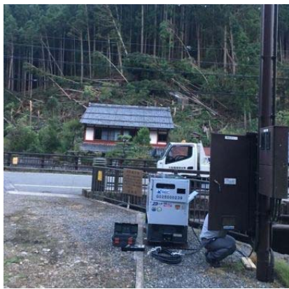
山間地域の被害と発動発電機の設置（左京区鞍馬）
