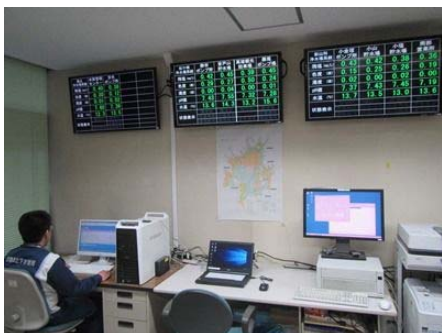
（水質自動監視装置の監視画面）
