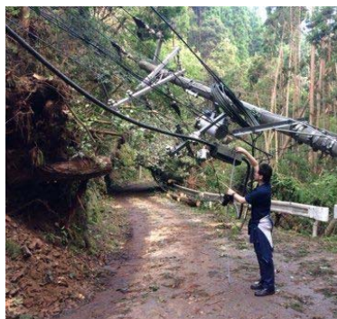
山間地域の被害（北区中川）
