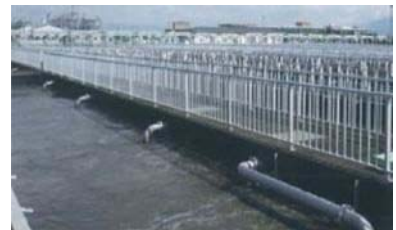
水処理施設（水環境保全センター）
