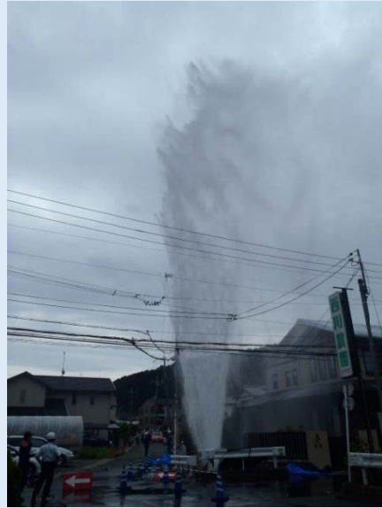
水道管からの漏水状況
