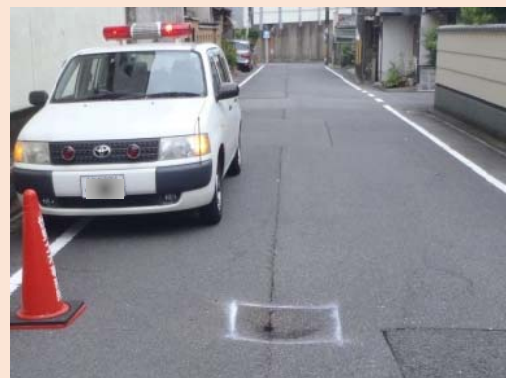
下水道管の破損による道路陥没
