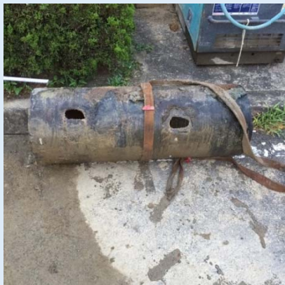
老朽化した水道管
