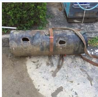
老朽化した水道管
