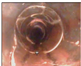
老朽管（施工前）
