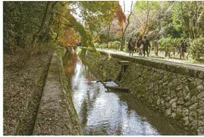
疏水分線から疏水園池への取水口 (O)
