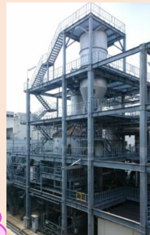
流動床式焼却炉 (鳥羽水環境保全センター)
