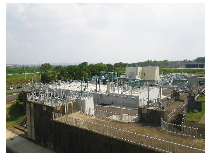
高速ろ過施設(伏見水環境保全センター) 大雨時に流入する大量の下水を連続してろ過することで河川への放流水質を向上させる施設です。
