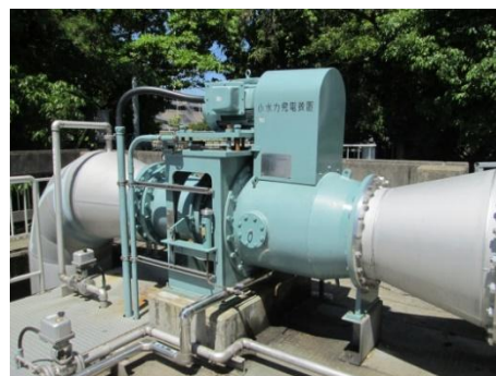
小水力発電設備(石田水環境保全センター) 定格出力: 9kW 発電実績: 72,860kWh(令和6年度)
