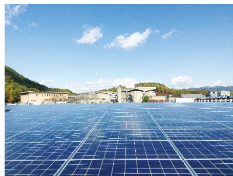
太陽光発電設備(新山科浄水場)
