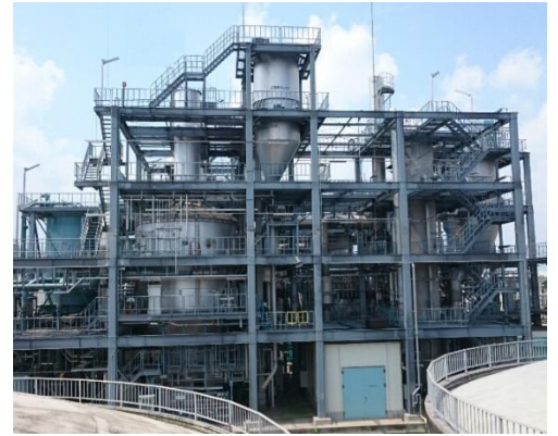
汚泥焼却炉(鳥羽水環境保全センター)
