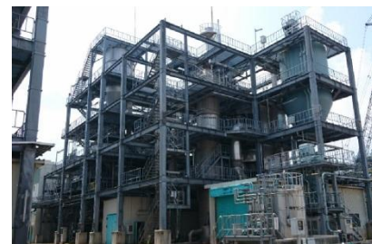
流動床式焼却炉の排煙処理設備 (鳥羽水環境保全センター)
