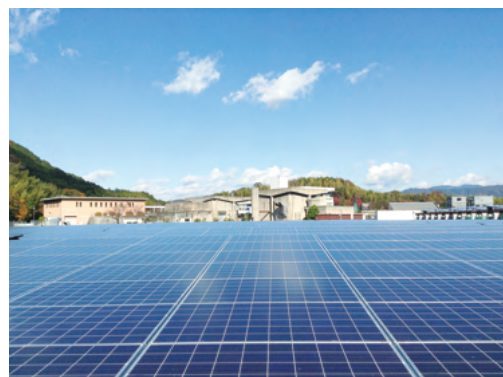
太陽光発電設備（新山科浄水場）
