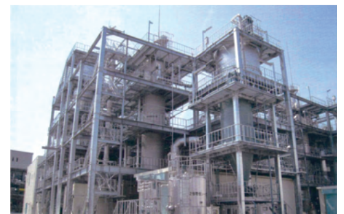
流動床式焼却炉の排煙処理設備
