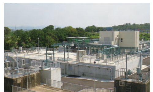
高速ろ過施設（伏見水環境保全センター）
