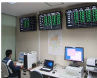
水質監視装置 監視画面
