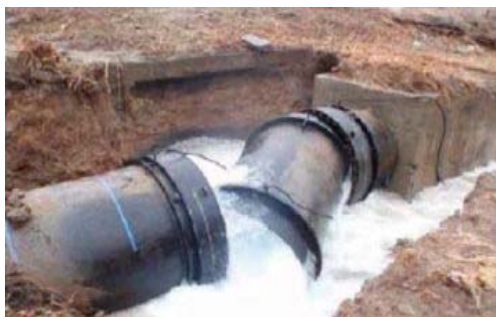
東日本大震災による水道管の継ぎ手離脱（宮城県）
