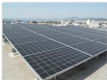
太陽光発電設備
