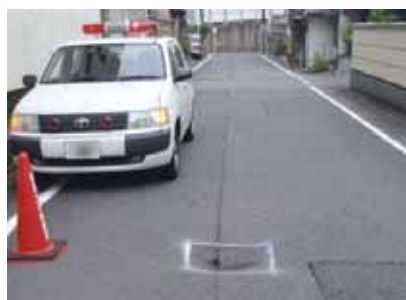
老朽化した下水道管の破損による道路陥没
