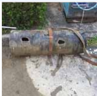
老朽化した水道管
