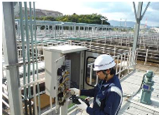
処理設備の点検状況
