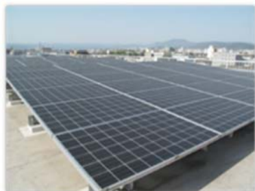
太陽光発電設備
