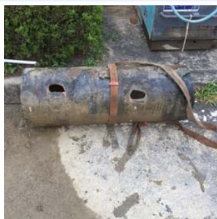
老朽化した水道管
