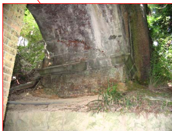
西側橋脚部ひび割れ
