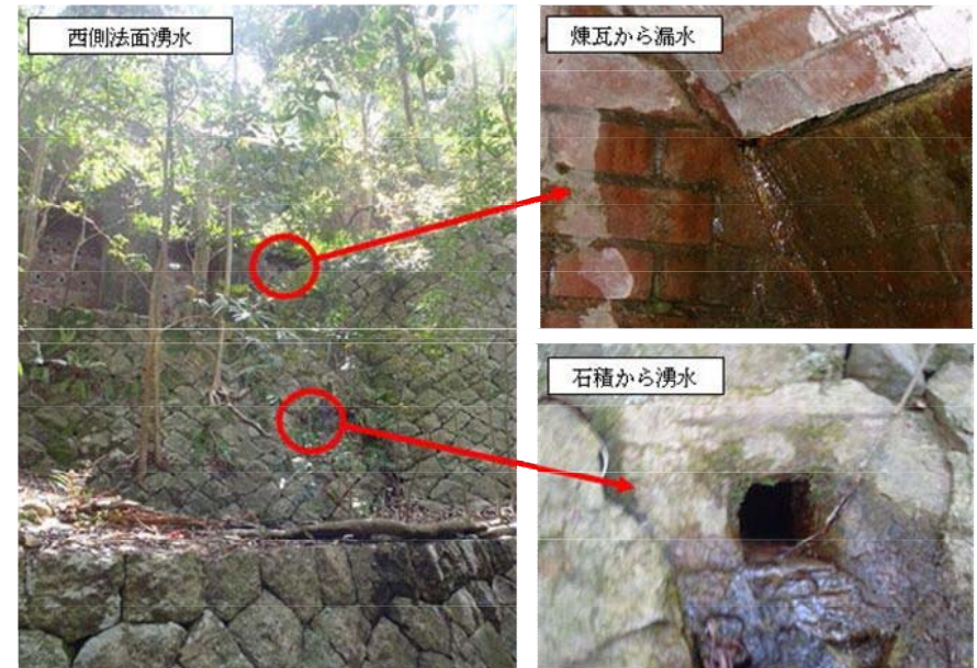
図-8 湧水(漏水)状況
