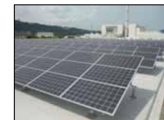
太陽光発電設備(石田水環境保全センター)
