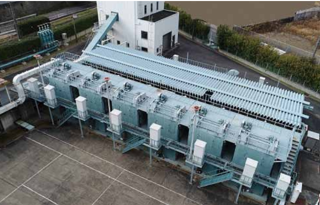
A系除じん機・沈砂池
