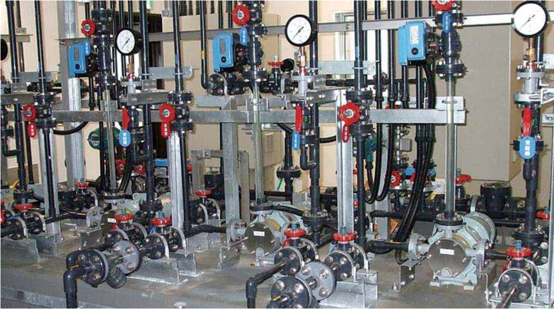
次亜塩素酸ソーダ注入ポンプ
