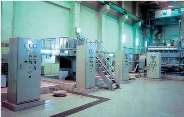
B系ポンプ場
