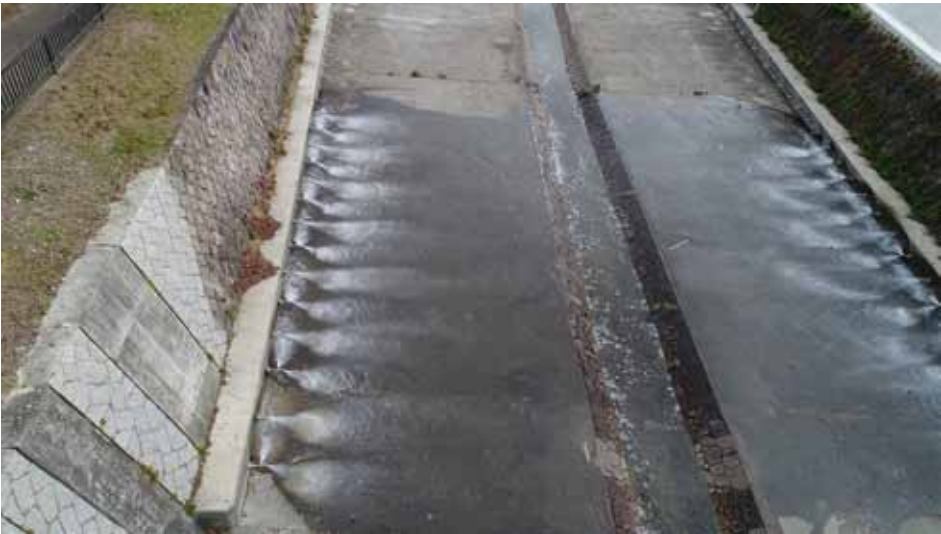
放流きょ周辺洗浄装置
