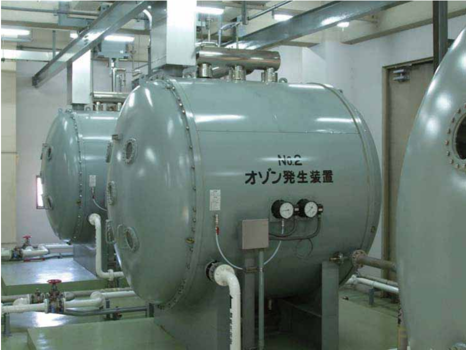
オゾン発生装置
