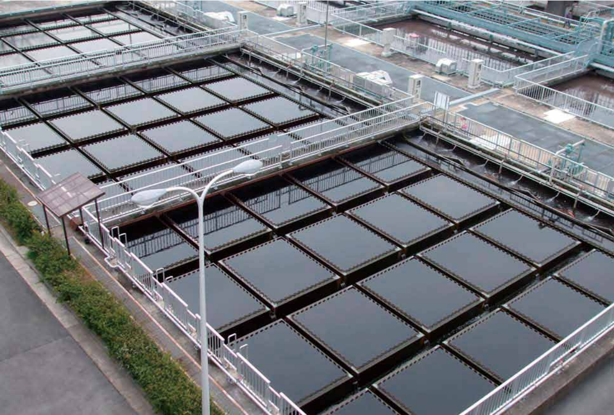
A系最終沈殿池
