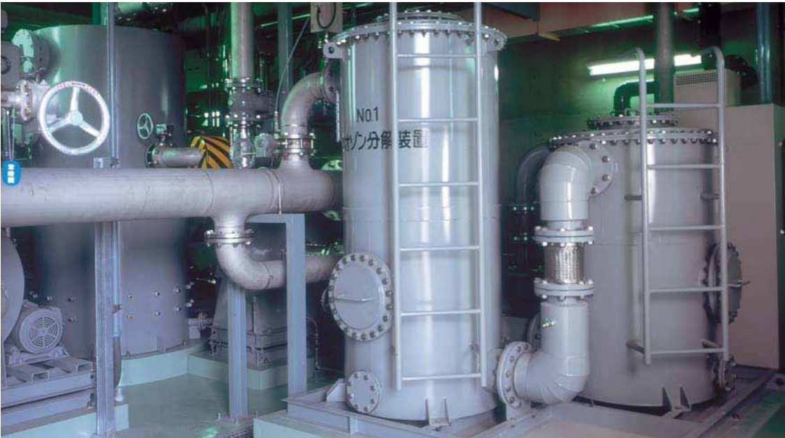
排オゾン分解装置
