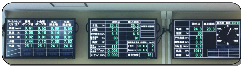
水質自動監視装置によるモニタリング
